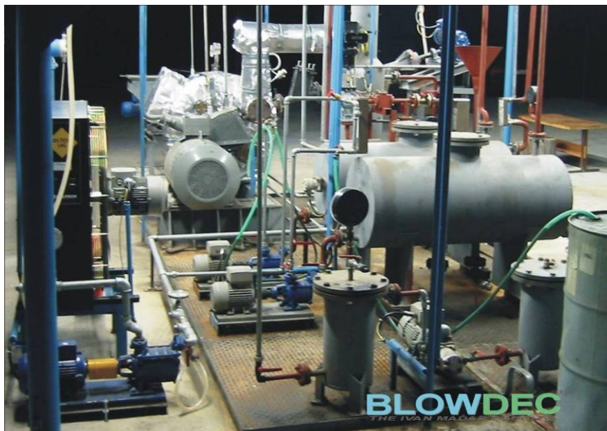
Výskumno-vývojová technologická jednotka BLOWDEC 45kW
